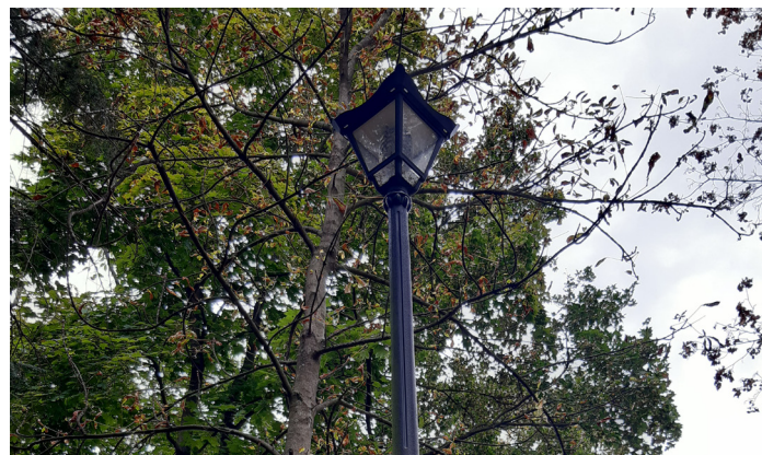
Tělesa veřejného osvětlení
